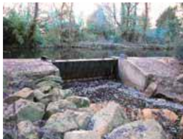
Photo 7 - Les ouvrages de régulation des niveaux d'eau : les pelles hydrauliques.
