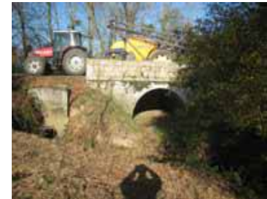
Photo 5 - L'Issoire, tronçon 1 : Illustration de l'approfondissement du lit mineur.
